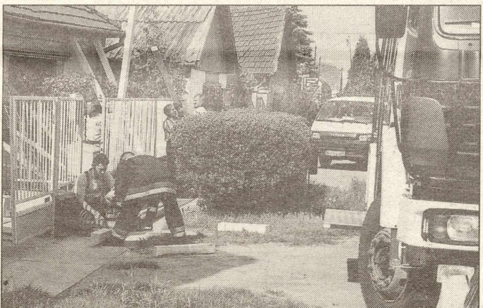
A kecskeméti tűzoltók ács munkában szereznek újabb jártasságot. Mostanában több új fagerendát kell beépíteniük a magas talajvíz miatt repedező házak falainak megtámasztására.
